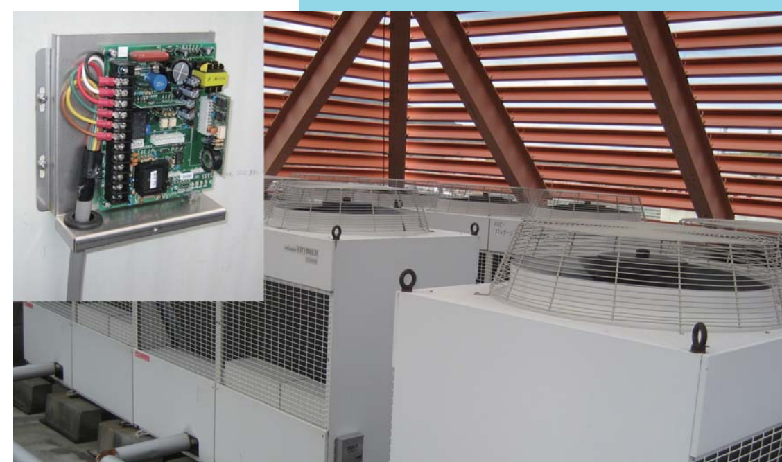
施設・設備の省エネ対策の一層の推進 (空調間欠制御器)
